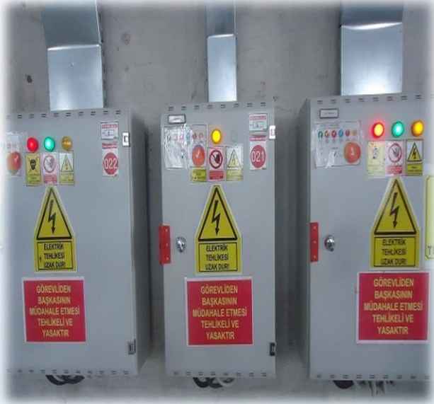
Demirciler HES Uyarı Levhaları
