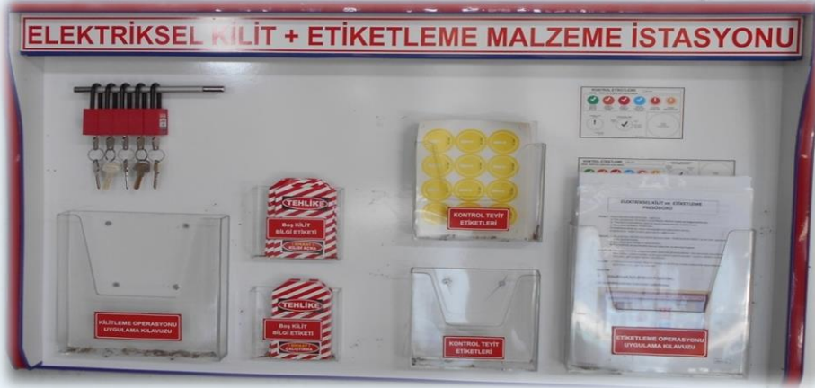
Kavakçalı HES Elektriksel Kilit+Etiketleme Malzeme İstasyonu
