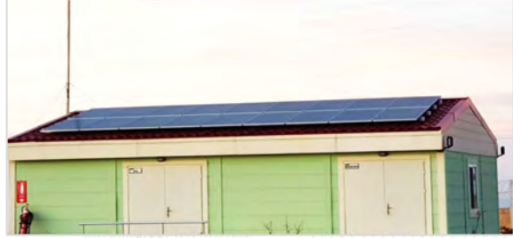
Resim 127 OMİCRON ENGL 208 Çatı Üstü Fotovoltaik Paneller
